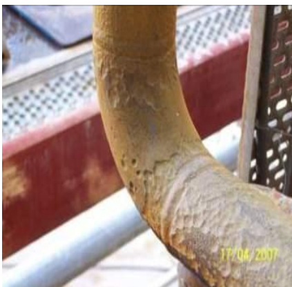
Så här illa kan det se ut under isoleringen.
