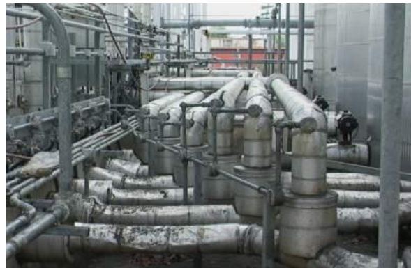
Skador på isolering är vanligt inom processindustri.
