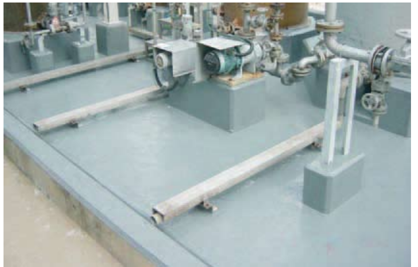
Idag finns det utvecklade produkter och metoder som klarar att skydda betongen mot de flesta kemikalier som idag används inom industrin upp till 200° C.
